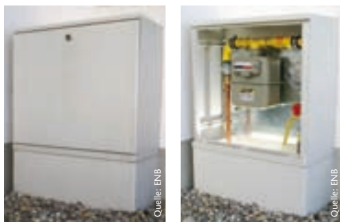
Hausanschlusskasten: geschlossen, offen
